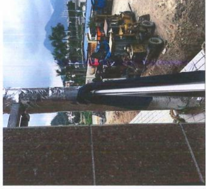
发电机废气排放口
