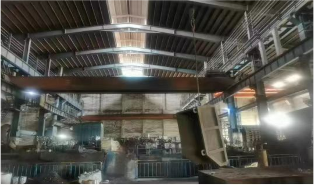
(图 1 铁斗卸料状态)
