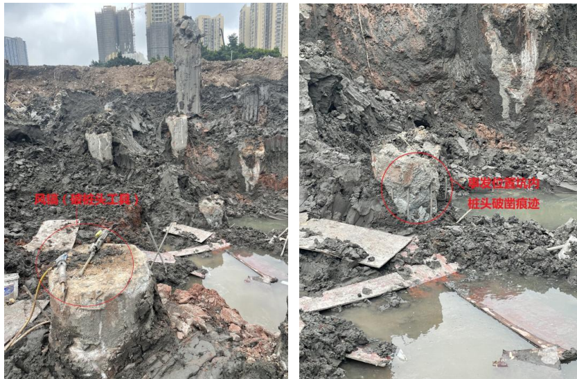
（图 8、图 9 工人被埋位置作业痕迹）
